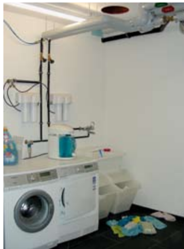
Schmutzige Wäsche wird mitten in der Schaltzentrale in der Praxis durch ein Loch ins den Keller befördert, wo sie vor die Waschmaschine zu liegen kommt. Über der Waschmaschine ist der Apparat ersichtlich, der das Wasser entionisiert, um für die Sterilisation das Wasser zu entsalzen.
